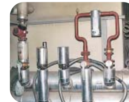
Ссылка: Установка прибора EWO 2" в байпас Трубопровод: Фирма Брунншмид ГмБХ, Вальдегг 6, А-6380 СТ. Иоганн
